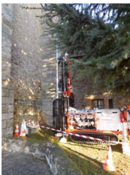
Recherche des causes des fissures
